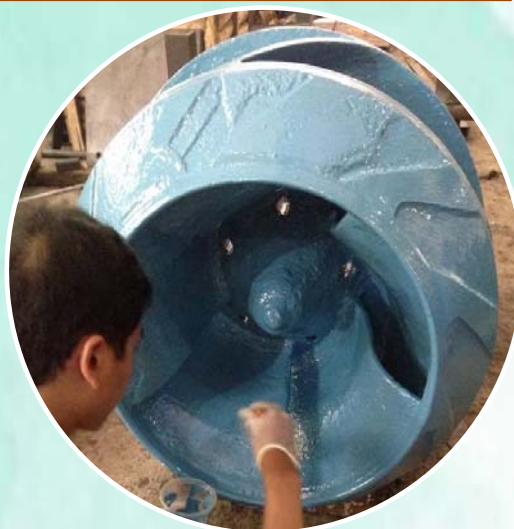
2. Phục hồi và phun phủ các quạt hút chân không của hệ thống vận chuyển tro bay - UB300MW
