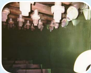
Phần bên trong hệ thống FGD
