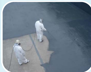
Các sản bê tông/ cốt thép
