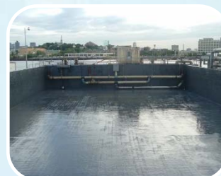
Hệ thống xử lý nước thải
